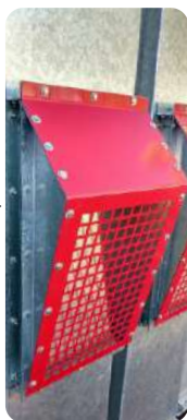
Calha com Janela de alívio de pressão
